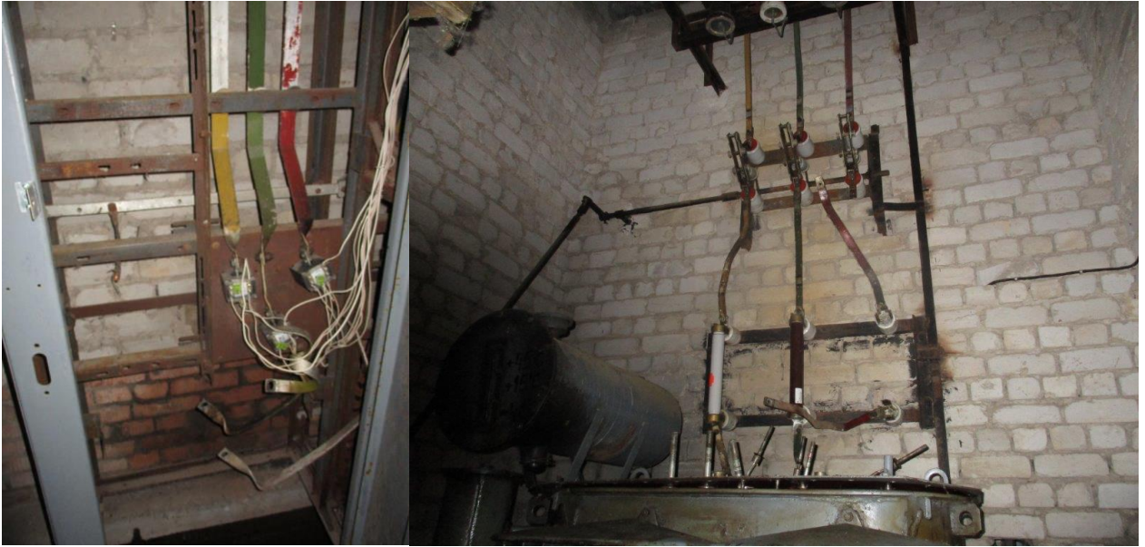
Разобранное оборудование ТП.
