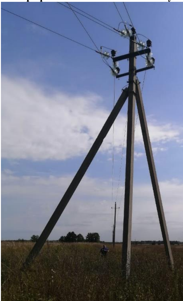
Общий вид места несчастного случая (опора №74 ЛЭП).
